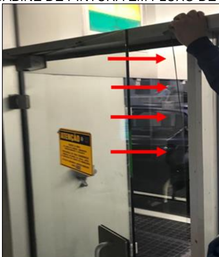
FIGURA 16 - CABINE DE PINTURA EM FLUXO DE AR NEGATIVO
