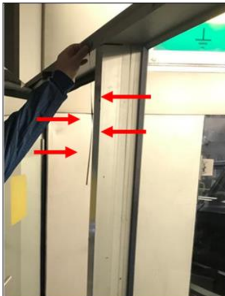
FIGURA 15 - CABINE DE PINTURA COM FLUXO DE AR NEUTRO
