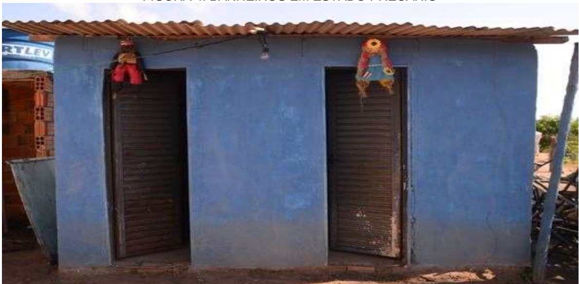
FIGURA 4: BANHEIROS EM ESTADO PRECÁRIO
